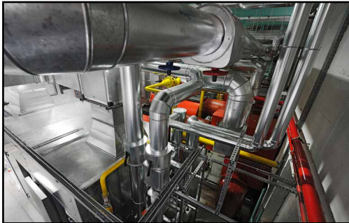
Bild: Technische Werke Schussental (TWS)
