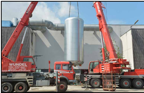
Bild: Technische Werke Schussental (TWS)
