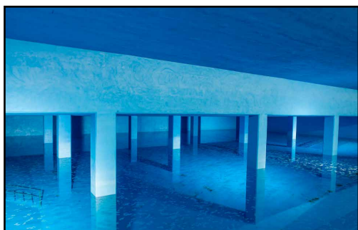
Bild: Technische Werke Schussental (TWS)
